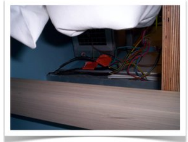
Fils électriques apparents et mal protégés (chambre hôtel récent)
