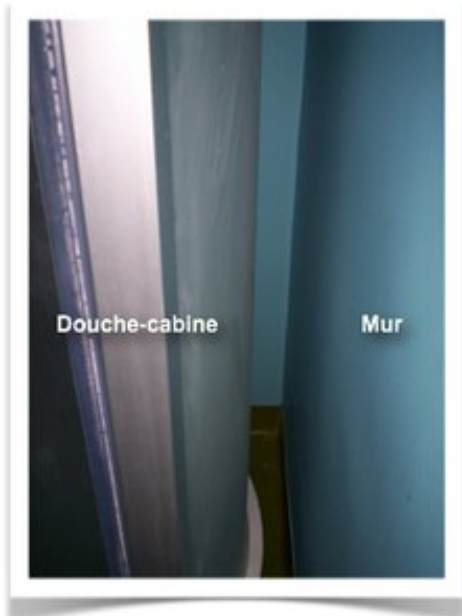
Espace entre mur et douche-cabine : nettoyage impossible ! (chambre hôtel récent)
